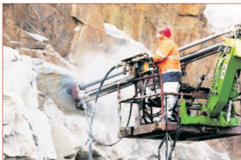
Jürgen Dankwart von der Dorfhainer Firma Jähmig bohrt an der Bischofswerdaer Ortsumfahrung mit einer schweren Maschine ein fast zehn Zentimeter starkes Loch in den Granit. Fünf Meter tief muss er bohren. Fotos: Daniel Schäfer
